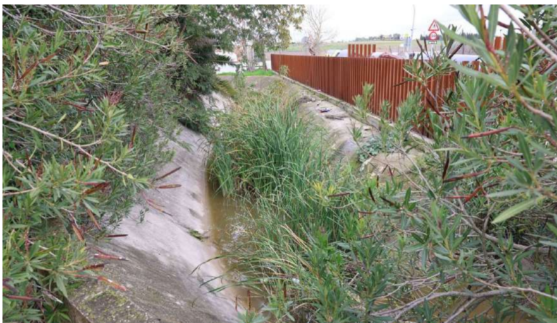
Un arroyo cercano a la zona por la que discurren las aguas fecales cuando llueve. JUAN CARLOS TORO
